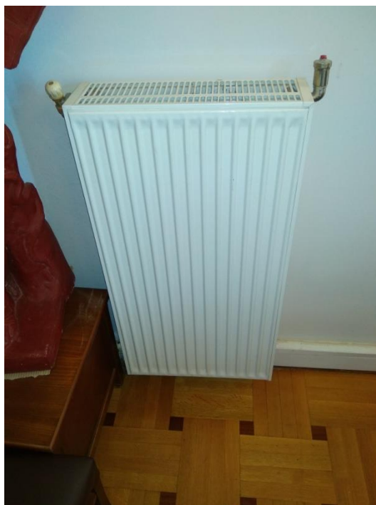
Τυπικό θερμαντικό σώμα κτιρίου
